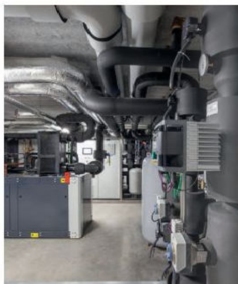
De technische ruimte herbergt onder meer de warmtepomp, gekoppeld aan een open KWO.
